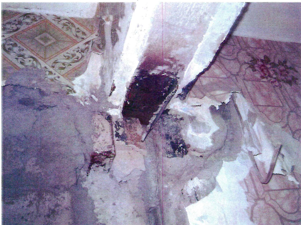
Фото 2 – Пример ослабления узла опирания прогона перекрытия на стеновую панель в связи с отступлением от проекта и коррозией.
