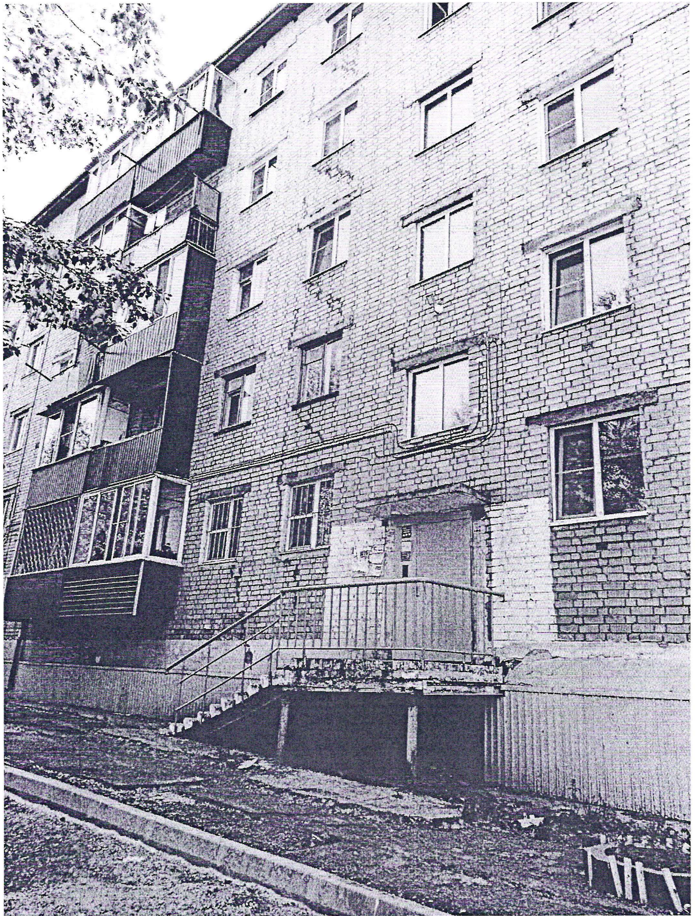
Фото 3. г. Чита, ул. 1-я Московская, д. 54 – закрыты продухи для проветривания подполья, трещины с раскрытием 10 - 30 мм
